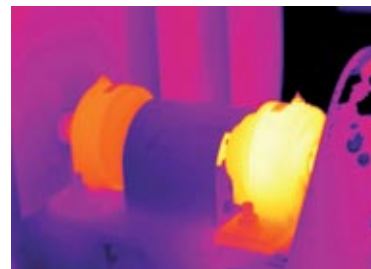
Перегрев крышки подшипника
